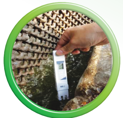
化學品濃度高及佈滿青苔的水塔
